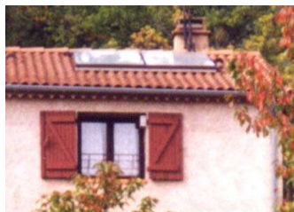
Captteurs solaires utilisés pour chauffer l'eau d'une maison individuelle (Alpes de Haute Provence)
